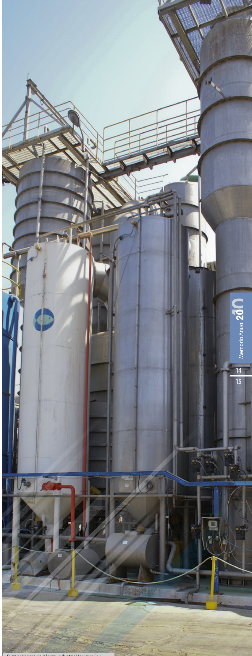
Evaporadores en planta industrial Iquique Sur
